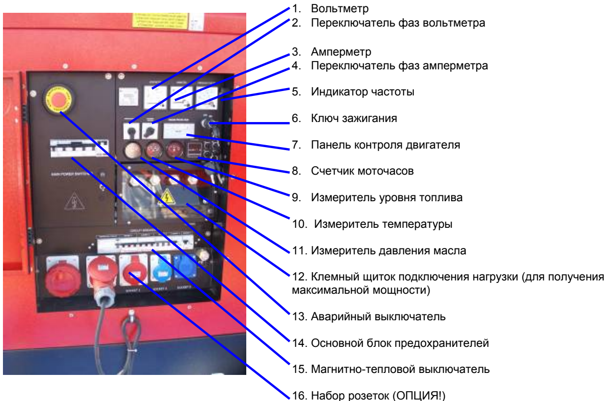
РИС.3 – Общая контрольно-коммутационная панель электростанции типа MS.
