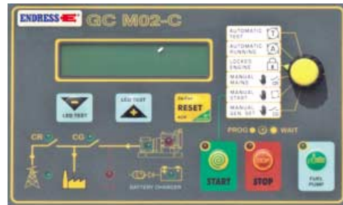
РИС.4 – Общая контрольно-коммутационная панель электростанции типа AS с блоком автоматики типа GC-M02
